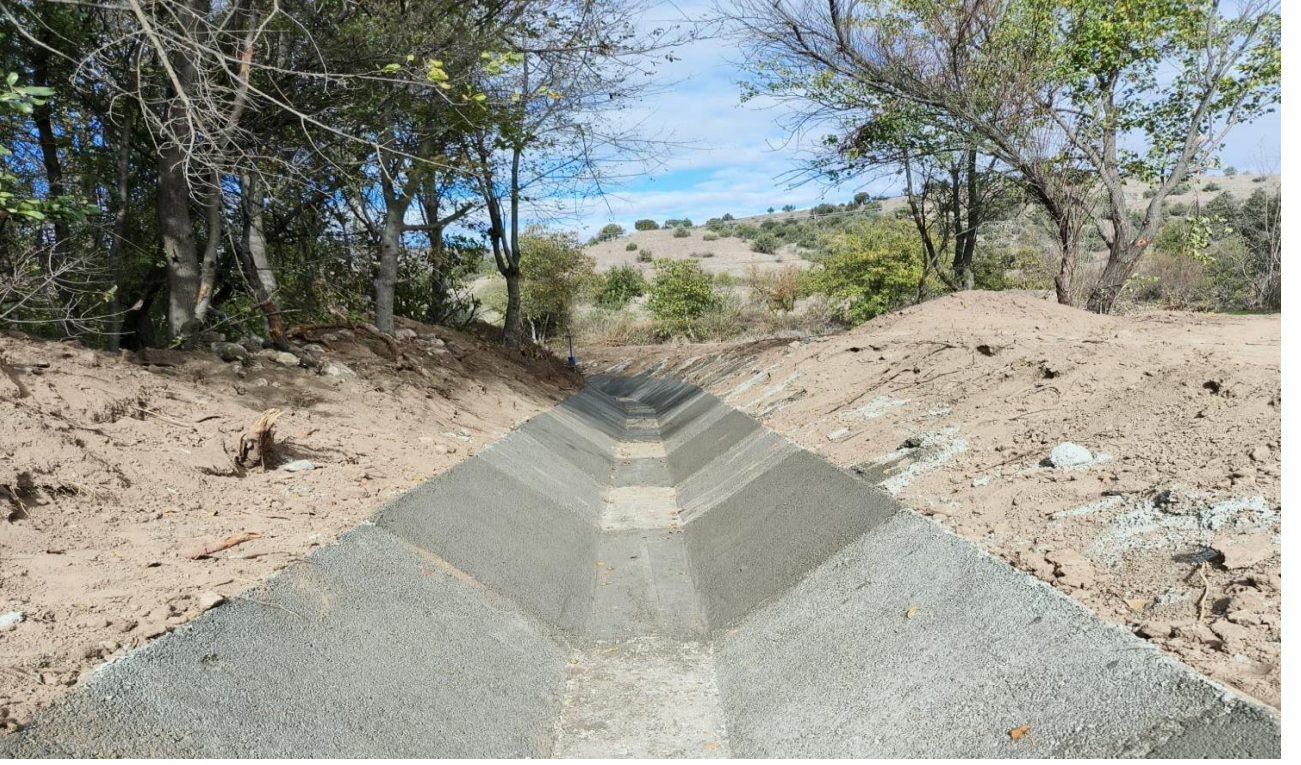
Ortaköy Senemoğlu Yerüstü Sulama Tesisi
