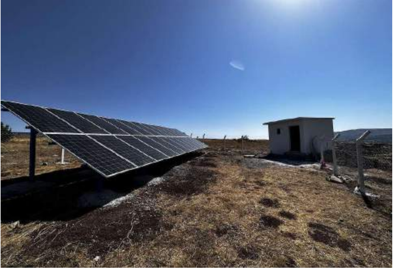
MERKEZ İLÇE KUTLUCA KÖYÜ - SONDAJ BİNASI TERFİ HATTI VE GES
