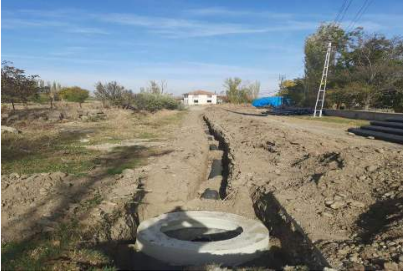
İSKİLİP İLÇESİ ŞEYH KÖYÜ KANALİZASYON TESİSİ
